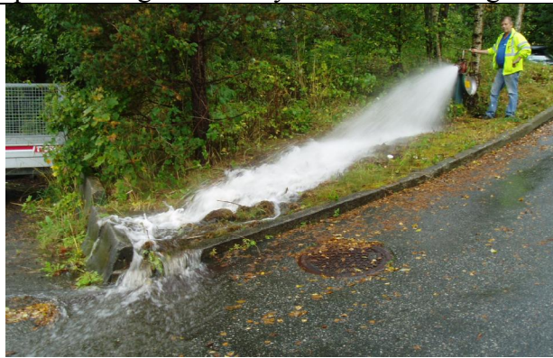
Fult åpne hydrant kan skade hage og vei
