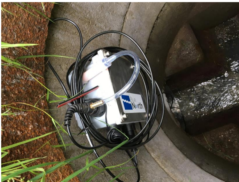
Doppler-måler og logger installert i felt med 3G/GPRS-kommunikasjon.. Foto: EcoLink AS
